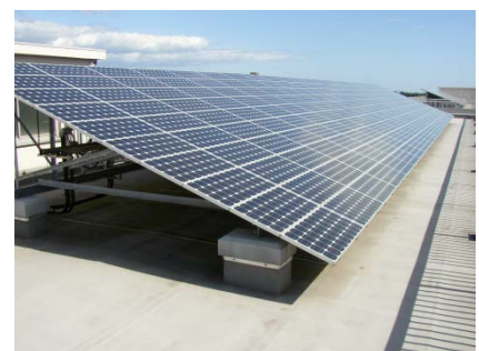
太陽光発電パネル (管理棟屋上)
