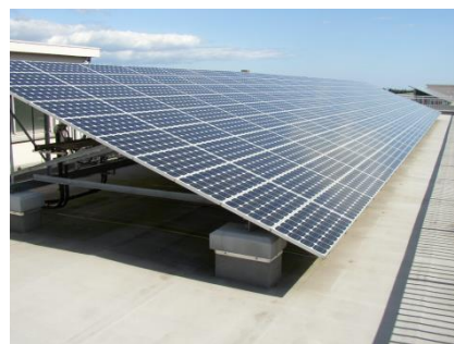
太陽光発電パネル (管理棟屋上)
